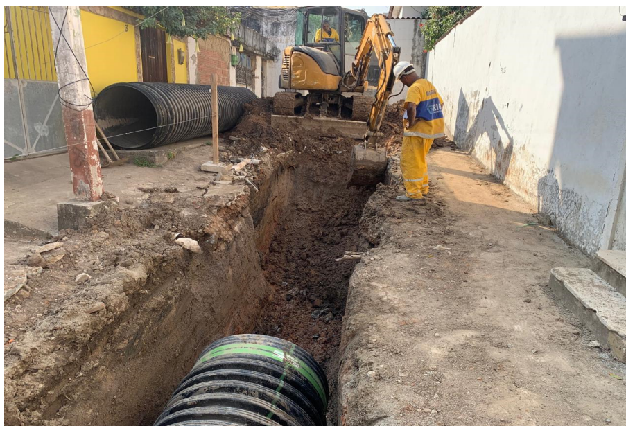
Foto 7: Obra de Drenagem na Rua Santo Sepulcro e outras, no bairro de Cascadura
