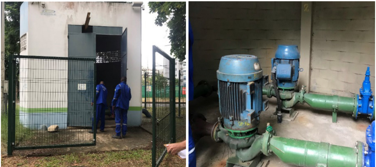
Figura 31. EEAT do tipo abrigada
