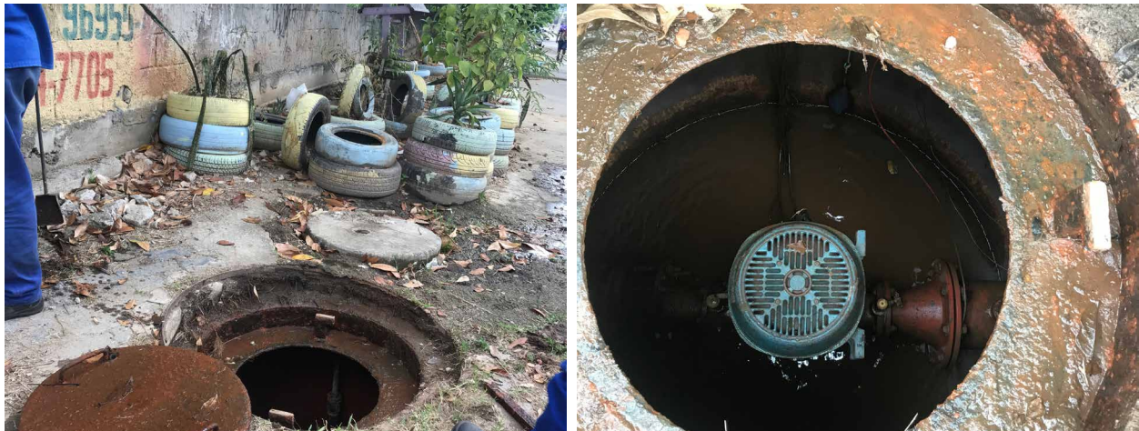
Figura 29. EEAT do tipo enterrada
