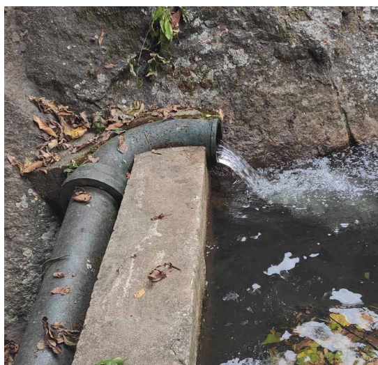
Figura 23. Água captada da Quininha para a barragem da Batalha
