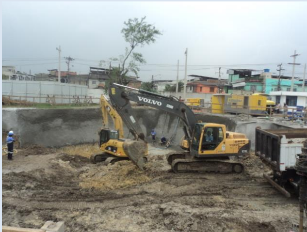
Elevatória MG 14.1 (ETE Deodoro)
