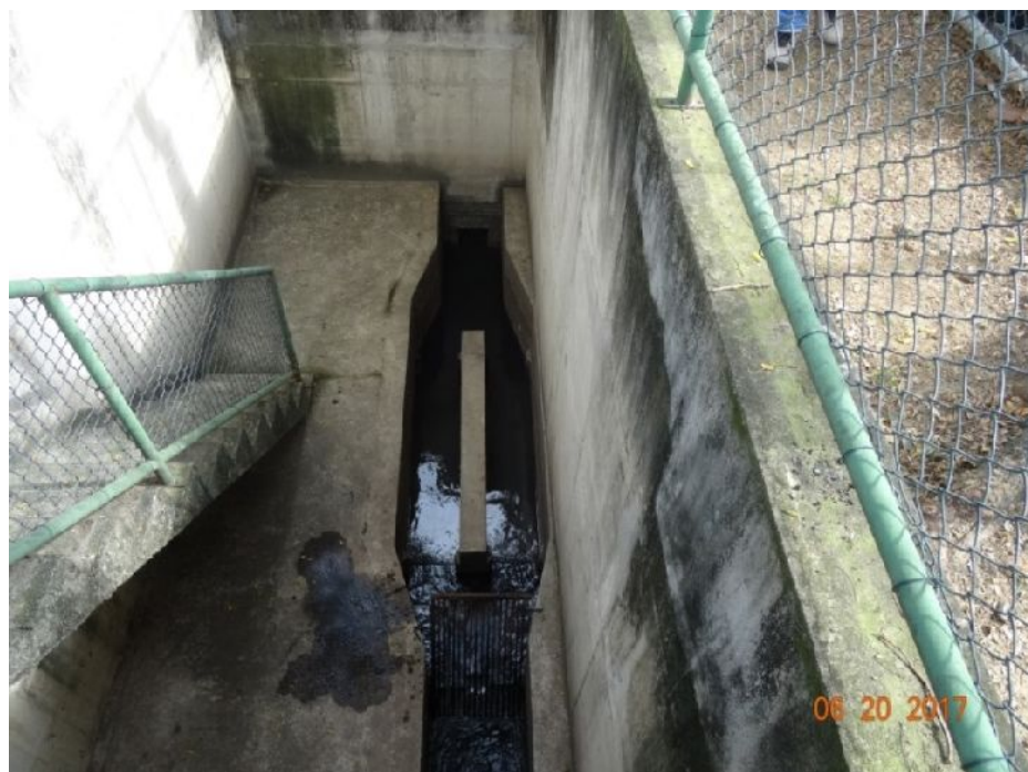
Figura 37: ETE Vila Mangueiral (Vistoria DIS/GFT)
