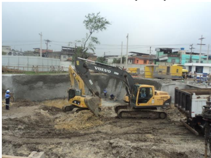
Elevatória MG 14.1 (ETE Deodoro)
